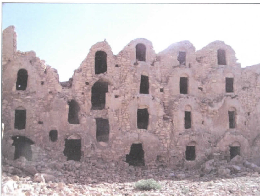
Photo 4 : un ksar abandonné et en ruine, Bou Harida (CL. auteur)
