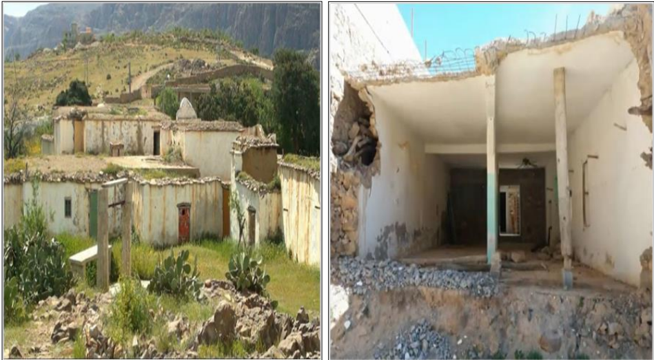
Photos 7-8 : Etat délabré de zawit juste avant les travaux de rénovation 1
